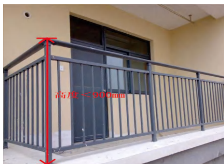
栏杆高度不足
