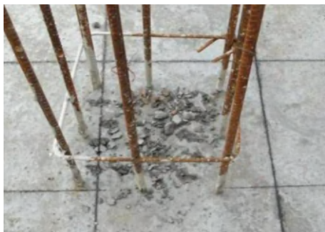
钢筋施工偏位
