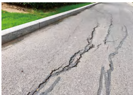
沥青路面裂缝
