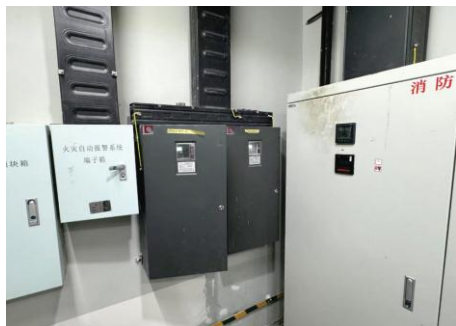
应急照明配电箱未采用下进线
