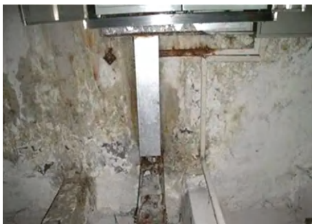
屋面变形缝渗漏
