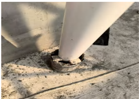
出屋面管道处理不到位渗水
