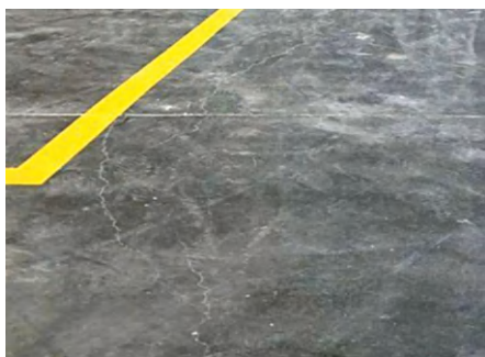
金刚砂地坪开裂
