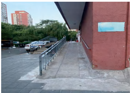
无障碍坡道、扶手安装不符合要求
