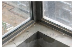
外窗部位渗漏
