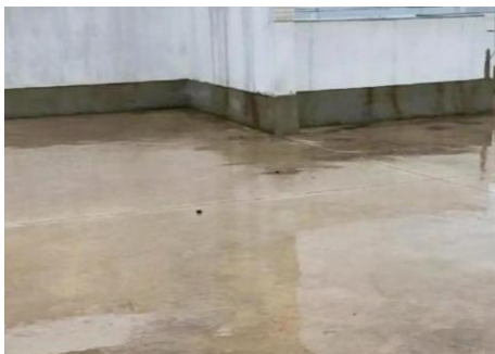
找坡层坡度、坡向不准确
