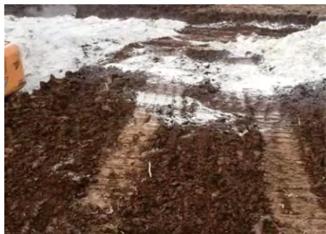
灰土未拌合均匀
