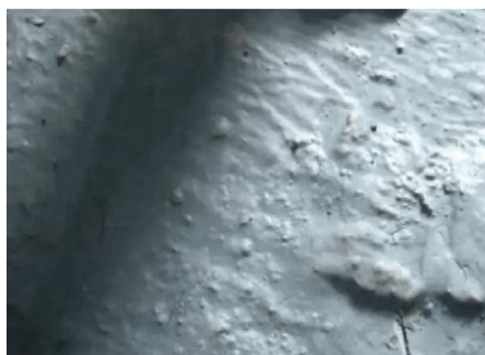
防水厚度不均匀、起皮、脱落
