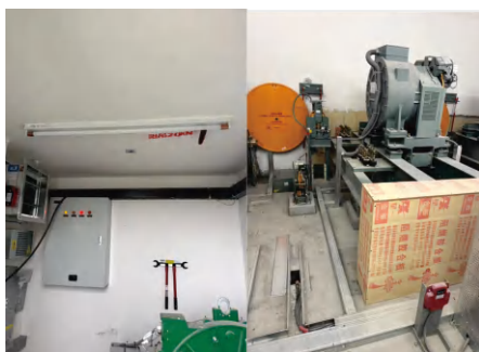
灯具在曳引机上方，接地失效
