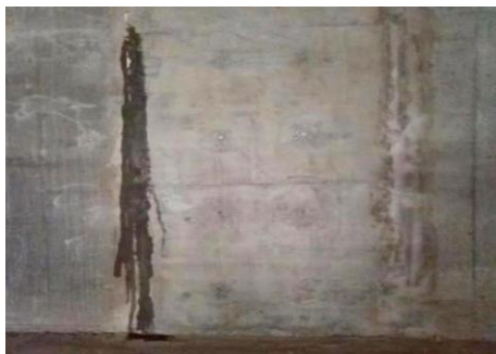
地下室后浇带渗漏
