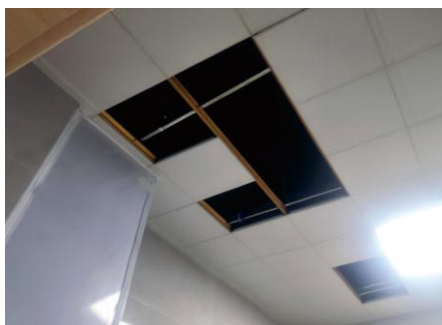
吊顶变形脱落
