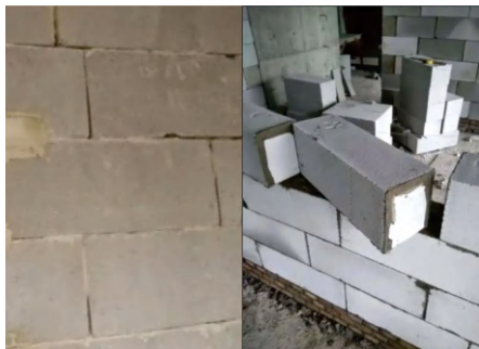
砖缝不饱满、灰缝不均匀
