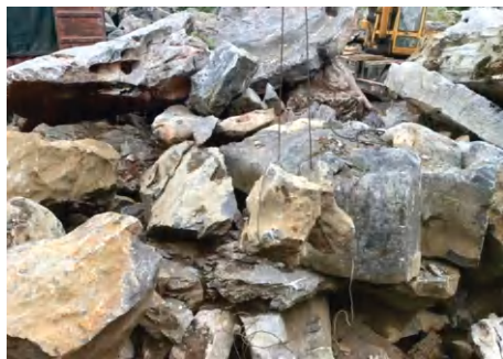
石制假山山体沉降、裂缝
