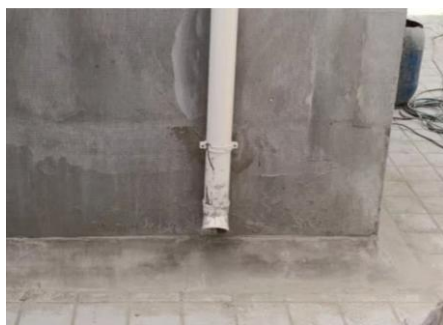
落水管下未安装水簸箕
