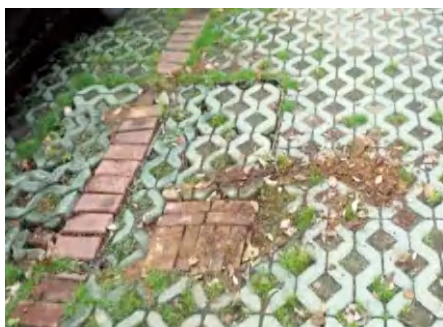
停车场植草砖沉陷、积水
