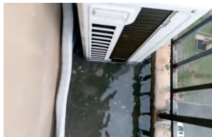
未设置导流槽渗漏
