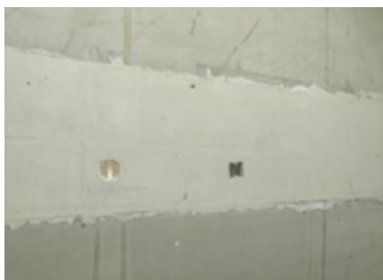
叠合板错台、漏浆
