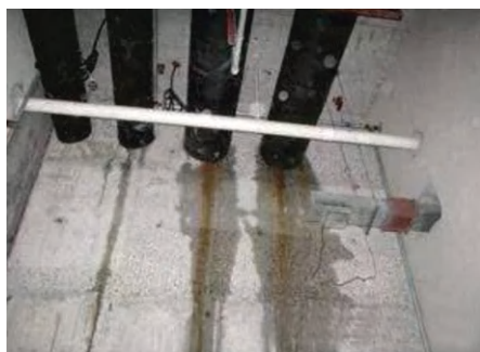
穿墙套管渗漏
