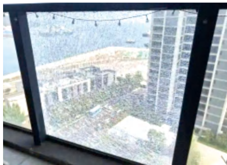
玻璃栏杆玻璃爆裂
