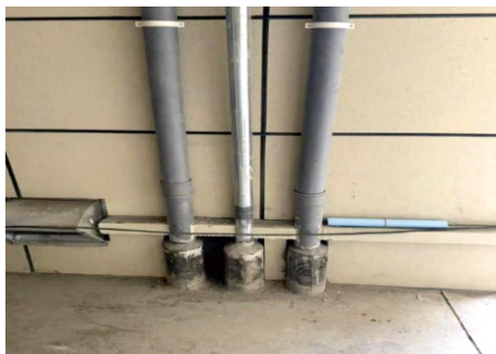
排水管道透气管施工错误
