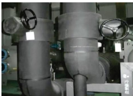
管道防腐保温影响使用功能
