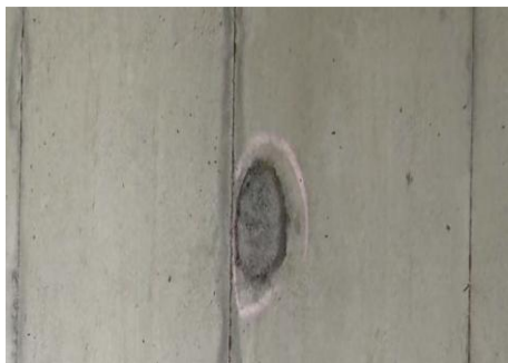
外墙螺杆洞渗漏
