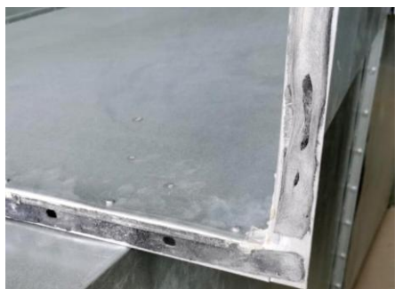
风管密封不严漏风严重
