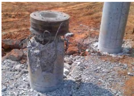
管桩桩头碎裂
