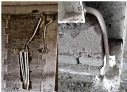
二次配管不规范破坏墙体
