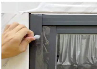
外窗气密性差、噪音过大
