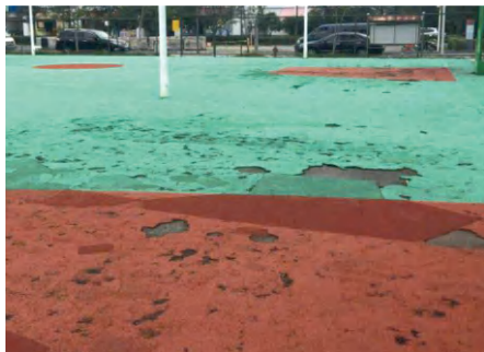
EPDM橡胶颗粒地面脱皮、开裂、鼓包
