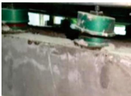
风机噪音过大
