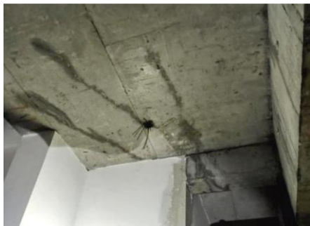
地下室顶板开裂渗漏
