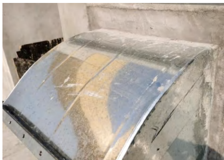
室外风管穿墙漏水
