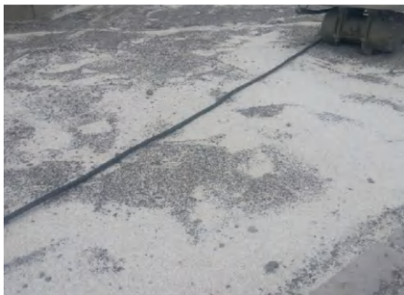
现浇泡沫混凝土保温层疏松、开裂
