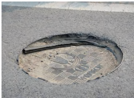
道路井盖周边沉降、突起
