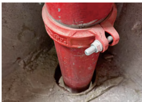
套管高度不足未封堵
