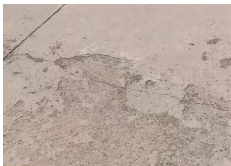
细石混凝土保护层开裂
