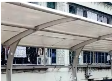
膜结构车棚膜面松弛、撕裂
