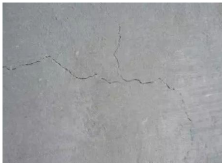
砂浆面层开裂、空鼓、脱落
