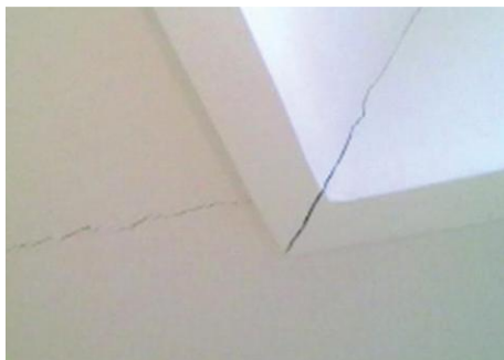
吊顶转角开裂
