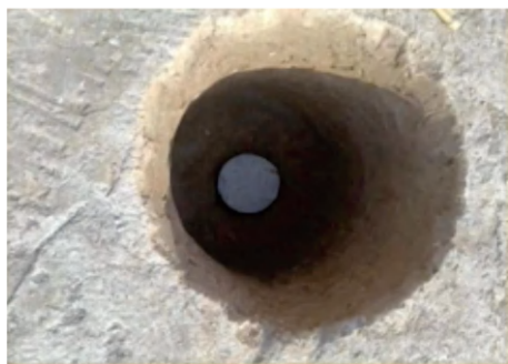
水泥粉煤灰碎石桩断桩
