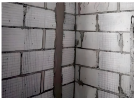
圈梁、构造柱、角柱缺失
