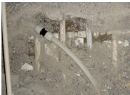
地辐热管道漏水
