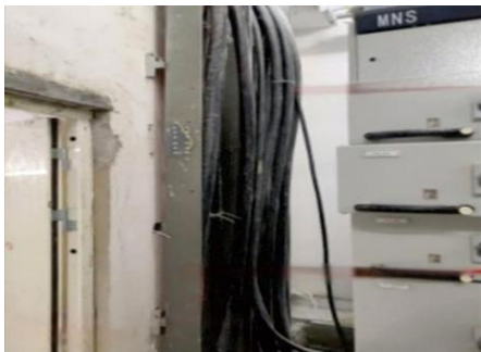
桥架内敷线存在缺陷
