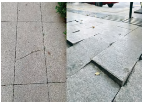
石材铺贴空鼓、断裂
