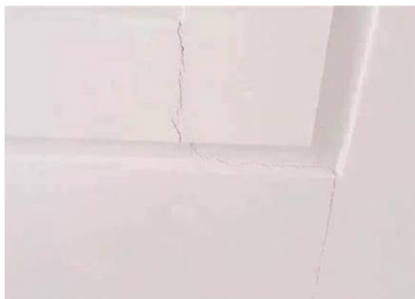
吊顶变形开裂
