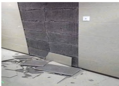
室内墙面贴砖空鼓、脱落
