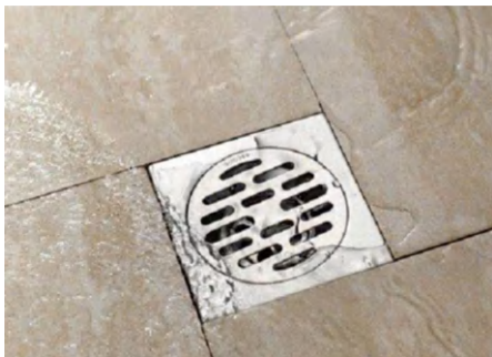
地漏排水不畅
