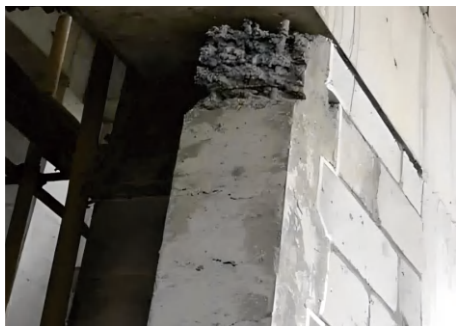
构造柱顶部不密实
