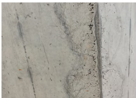
混凝土蜂窝麻面
