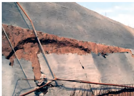
土钉墙支护面层开裂脱落
