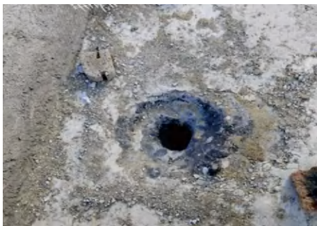
屋面水落口渗漏
