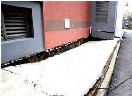
回填土下沉、塌陷
