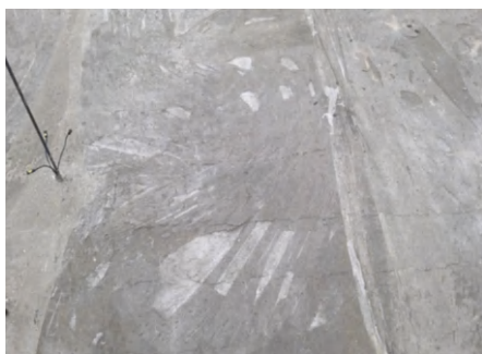
大体积混凝土冷缝、裂缝
