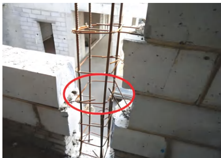
拉结筋与构造柱锚固不规范
