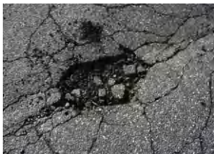
沥青路面起皮、脱落
