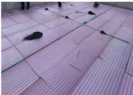
板状材料保温层铺设质量问题
