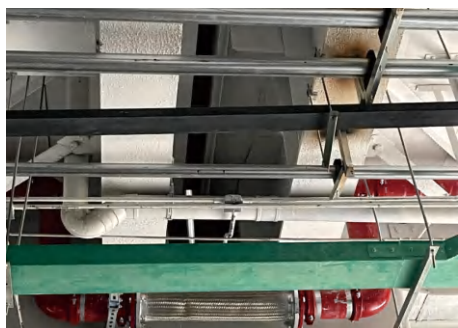
管线穿越变形缝未采取抗变形措施
