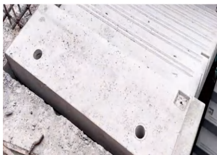
预制楼梯安装标高有误
