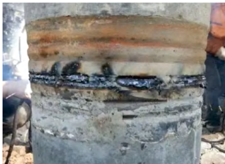
管桩接头焊接缺陷
