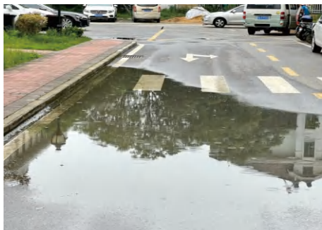
道路排水沟、路面存在积水、排水不畅
