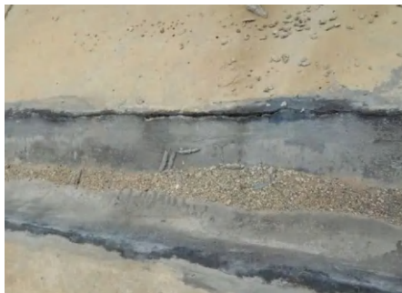
屋面天沟排水不畅
