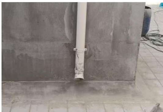
落水管下未安装水簸箕
