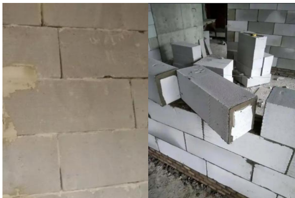
砖缝不饱满、灰缝不均匀
