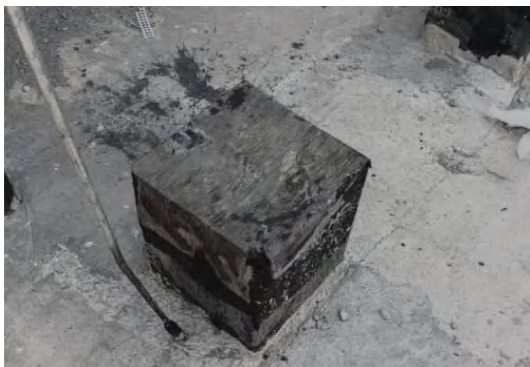
屋面设备基础防水处理不到位导致渗漏
