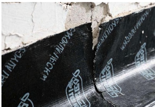
屋面女儿墙防水细部处理不到位出现渗漏
