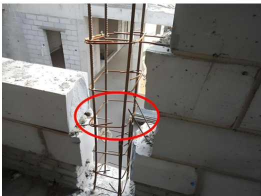
拉结筋与构造柱锚固不规范
