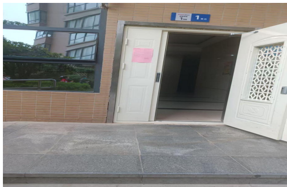
入户平台宽度不足，门内外高差大于15mm
