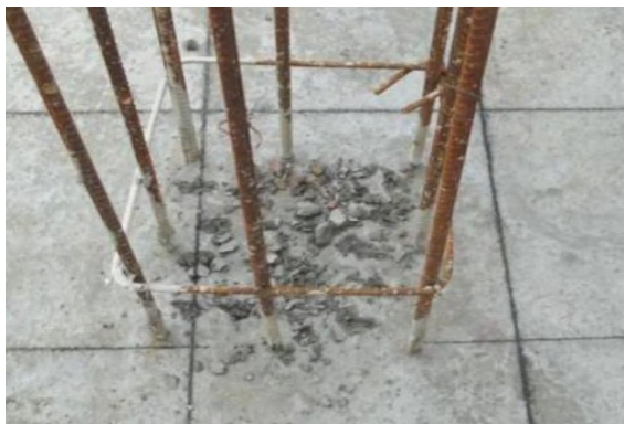
钢筋施工偏位
