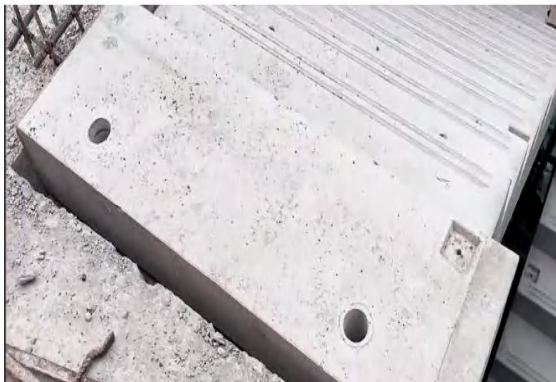
预制楼梯安装标高有误
