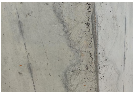
混凝土蜂窝麻面
