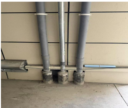
排水管道透气管施工错误
