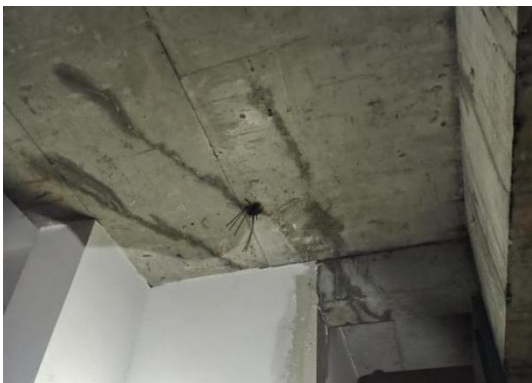
地下室顶板渗漏
