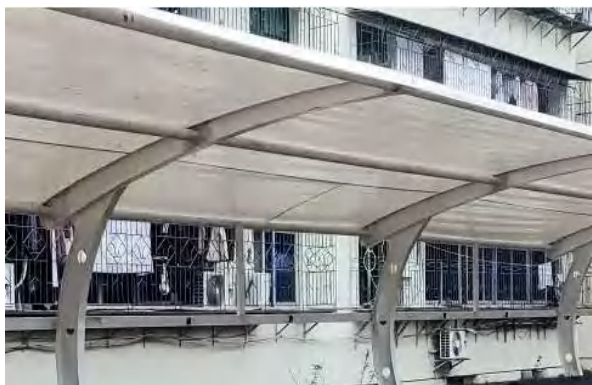
膜结构车棚膜面松弛、撕裂
