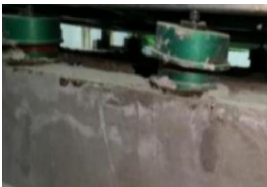
风机噪音过大
