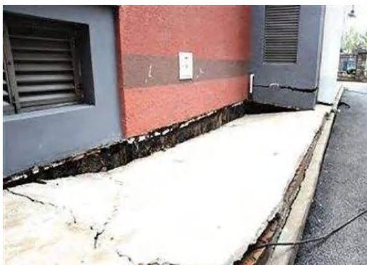
回填土下沉、塌陷
