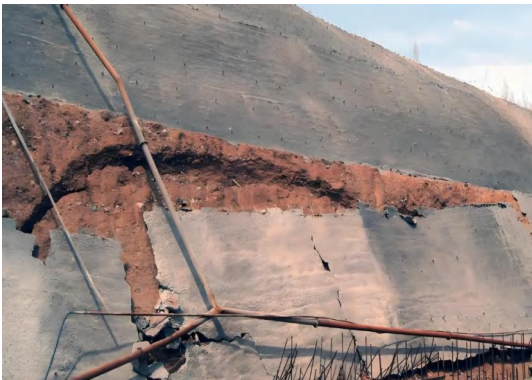
土钉面层开裂脱落
