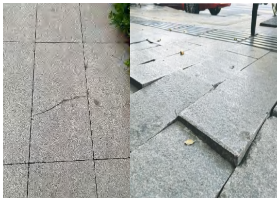
石材铺贴空鼓、断裂
