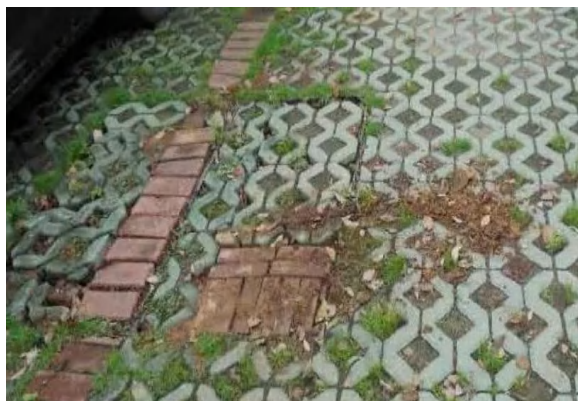
停车场植草砖沉陷、积水
