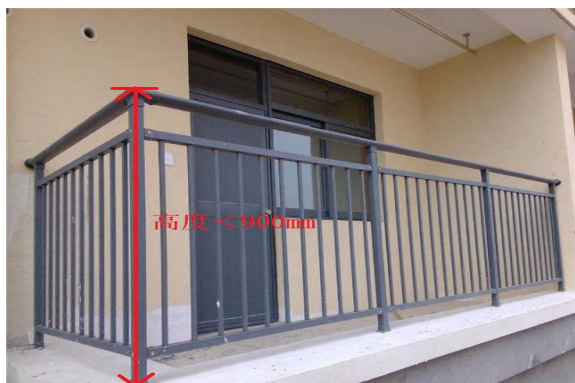
栏杆高度不足
