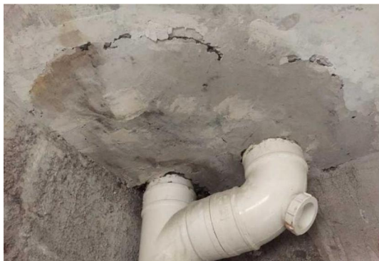
屋面水落口渗漏
