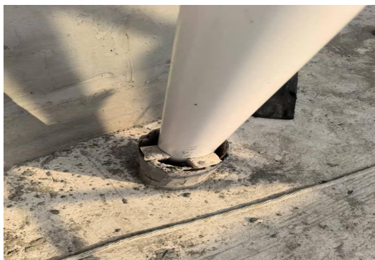
出屋面管道处理不到位渗水
