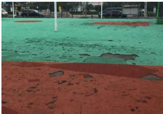
EPDM橡胶颗粒地面脱皮、开裂、鼓包
