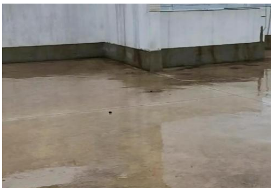
找坡层坡度、坡向不准确
