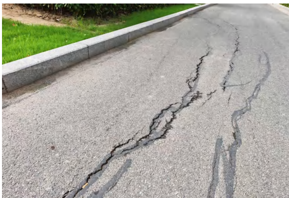
沥青路面裂缝
