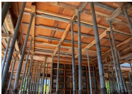
模板起拱度不足
