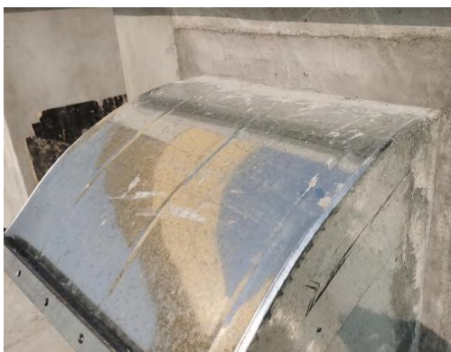
室外风管穿墙漏水
