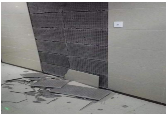
室内墙面贴砖空鼓、脱落
