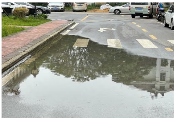
道路排水沟、路面存在积水、排水不畅
