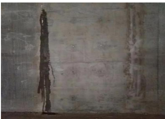
地下室后浇带渗漏
