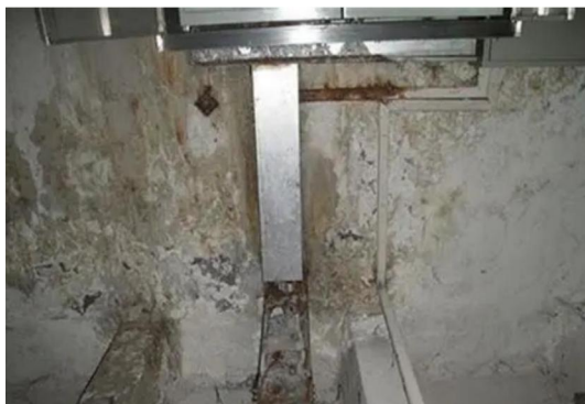
屋面变形缝渗漏
