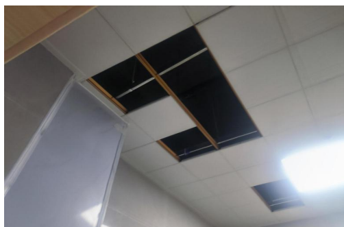
吊顶变形脱落
