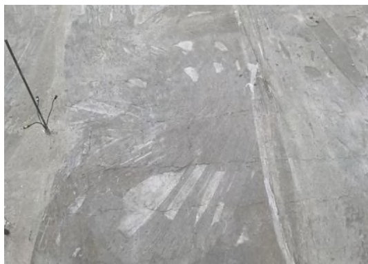
大体积混凝土冷缝、裂缝
