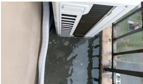
未设置导流槽渗漏
