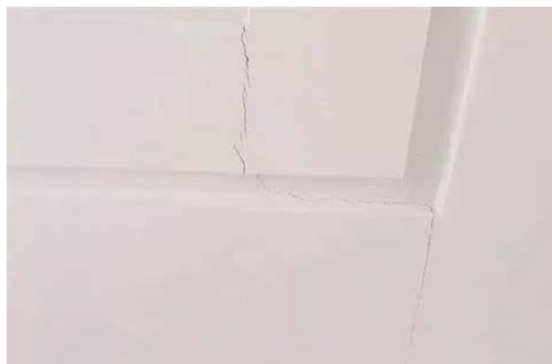
吊顶变形开裂
