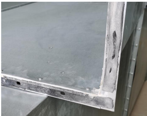
风管密封不严漏风严重
