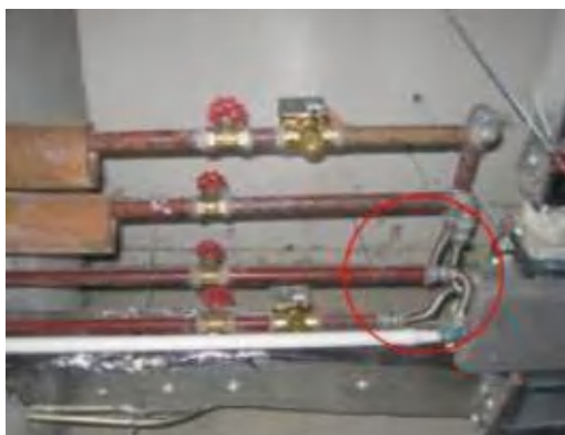
管道支架缺失影响使用功能
