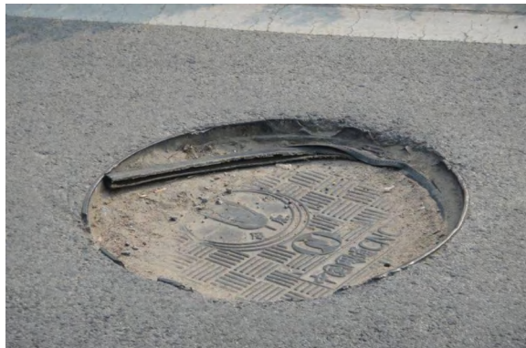
道路井盖周边沉降、突起
