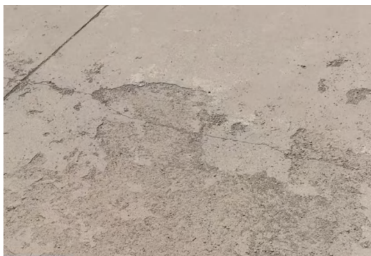
细石混凝土保护层开裂
