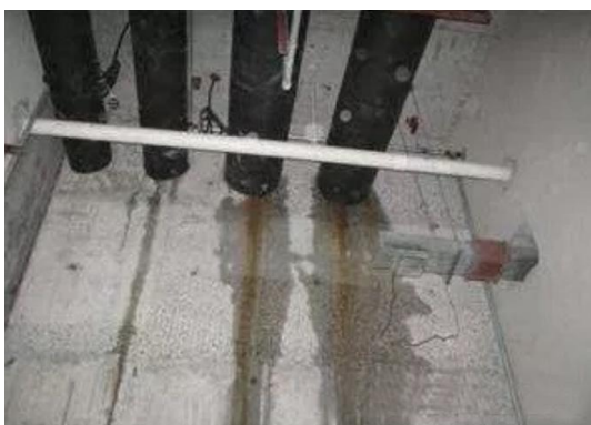
外墙螺杆眼渗漏
