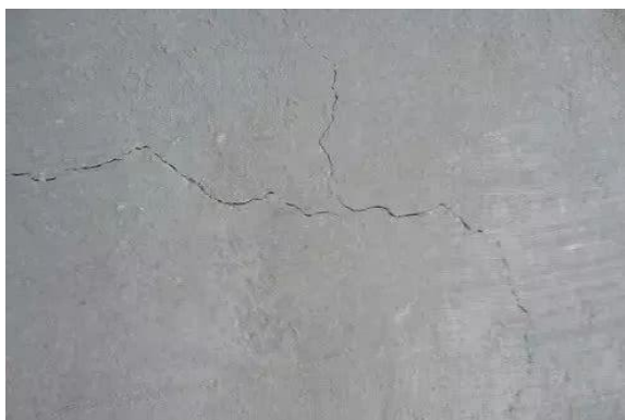
砂浆面层开裂、空鼓、脱落
