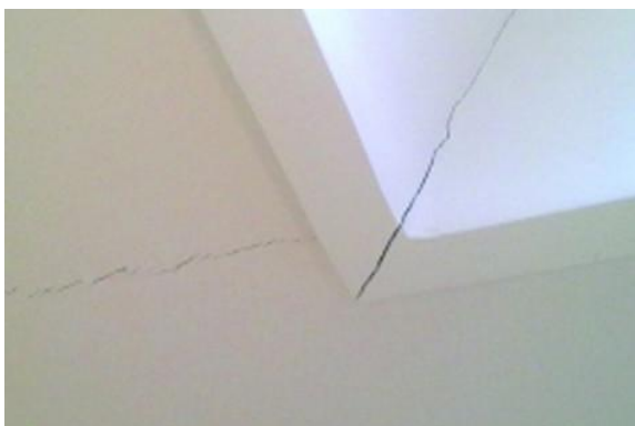
吊顶转角开裂
