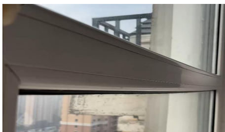
窗框型材弯曲变形
