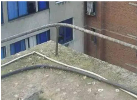
屋面接地安装缺陷
