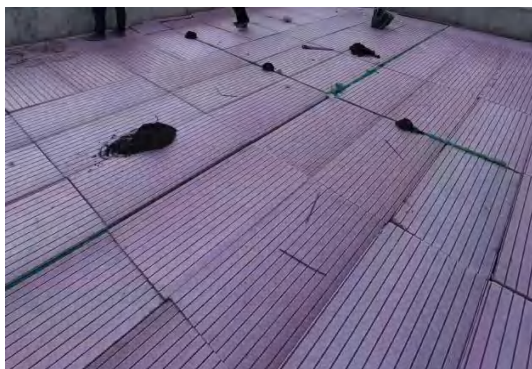
板状材料保温层铺设质量问题
