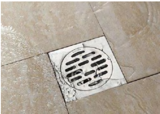
地漏排水不畅
