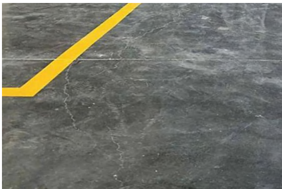
金刚砂地坪开裂
