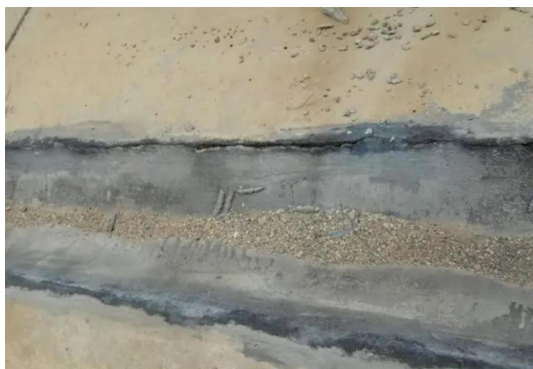
屋面天沟排水不畅
