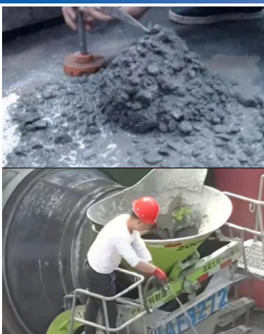
混凝土坍落度损失过大、泌水、离析 施工时往混凝土中私自加水
