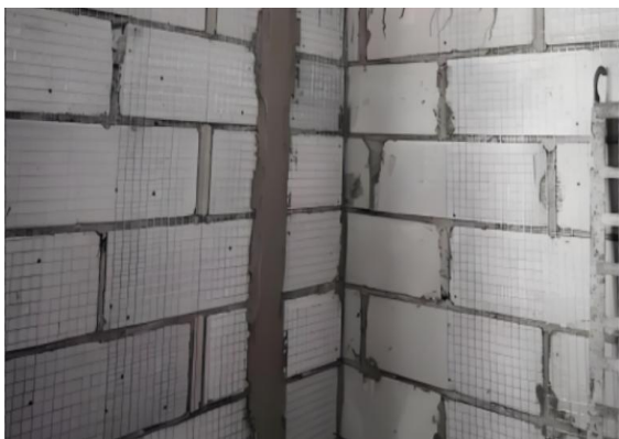
圈梁、构造柱、角柱缺失
