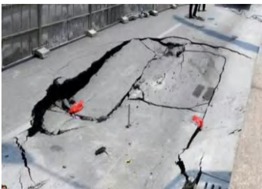
基坑周边地面沉降
