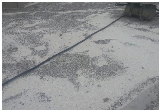
现浇泡沫混凝土保温层疏松、开裂
