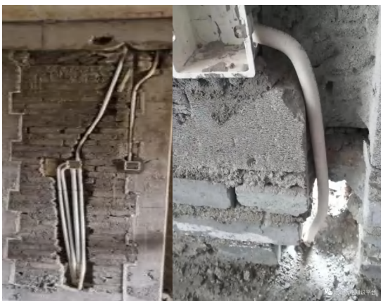
二次配管不规范破坏墙体
