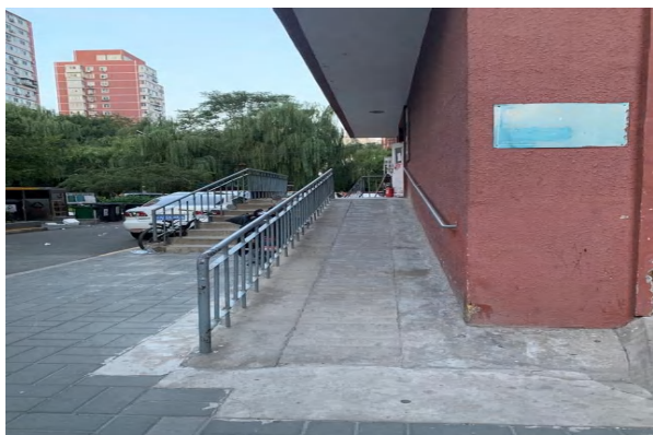
无障碍坡道、扶手安装不符合要求
