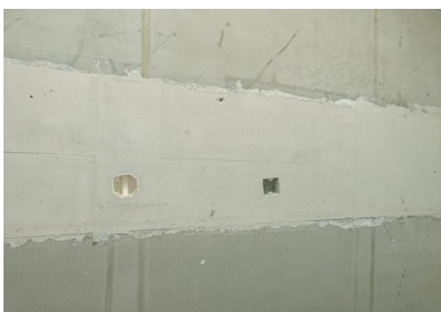
叠合板错台、漏浆
