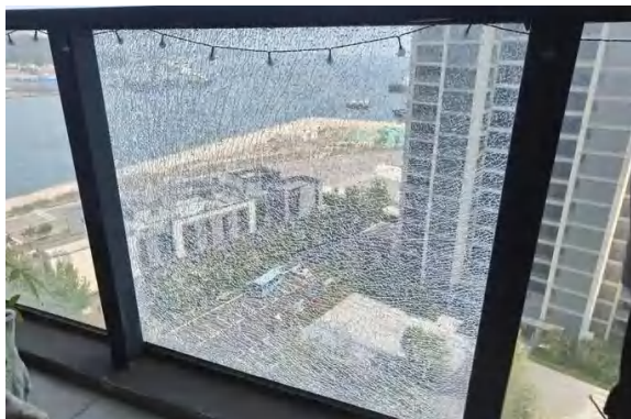
玻璃栏杆玻璃爆裂
