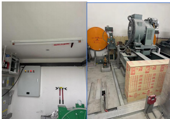
灯具在曳引机上方，接地失效
