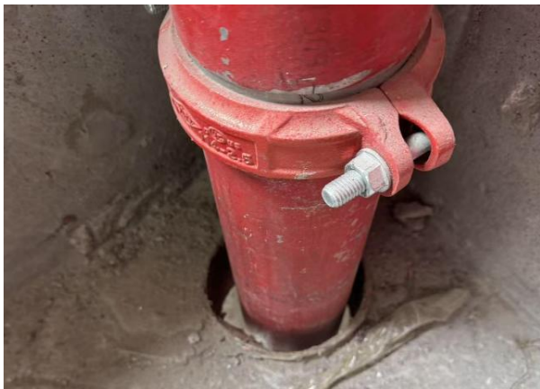
套管高度不足未封堵
