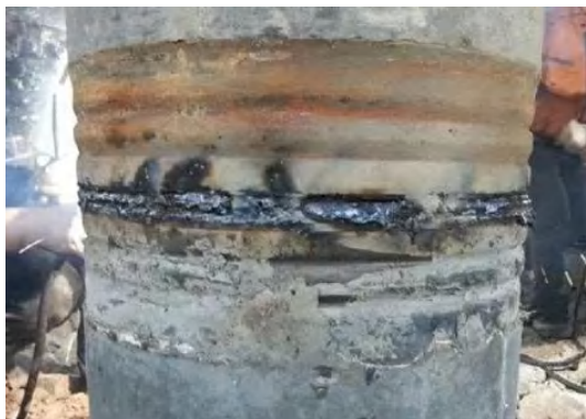
管桩接头焊缝不饱满、夹渣
