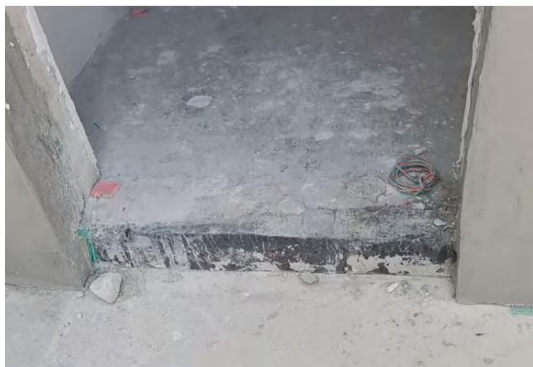
出入屋面门槛高度不足、卷材细部处理不规范
