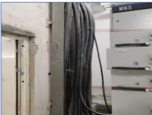
桥架内敷线存在缺陷
