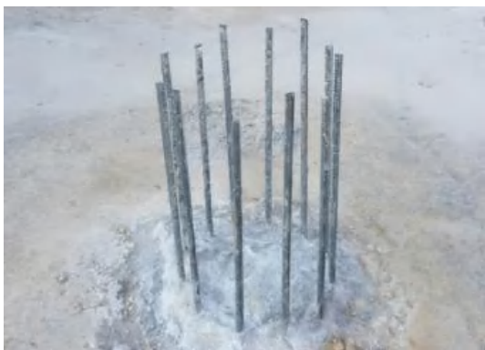
桩头不平整，钢筋根部未安装止水条
