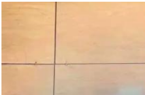
墙面贴砖拼缝不平、宽窄不均
