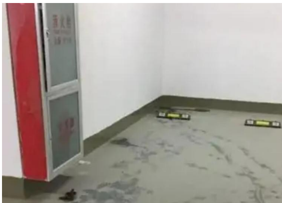
消火栓被遮挡
