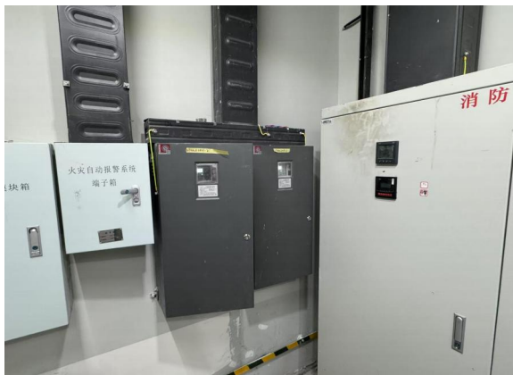
应急照明配电箱未采用下进线
