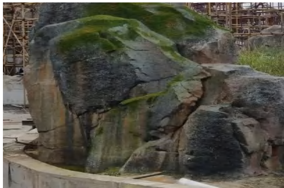
塑石假山山体面层裂缝、脱落
