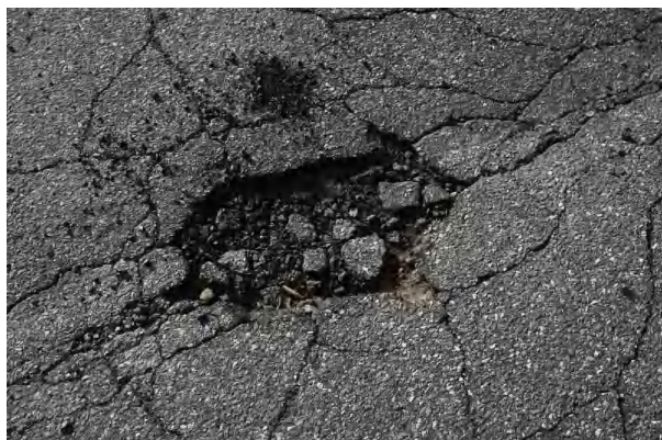
沥青路面起皮、脱落
