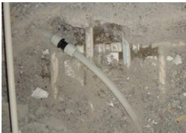
地辅热管道漏水
