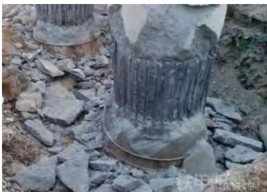
桩头剔凿破损
