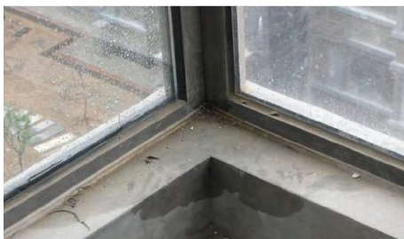
外窗部位渗漏
