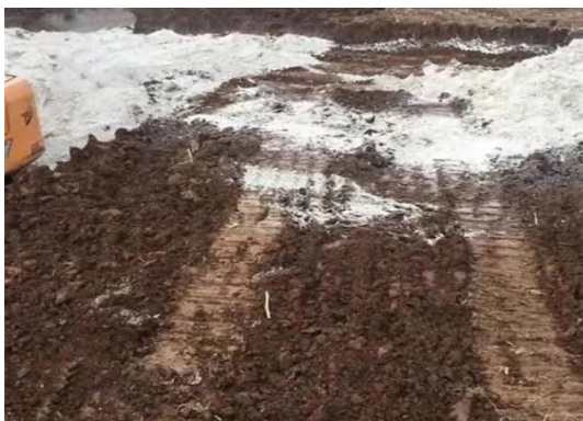
灰土未拌合均匀
